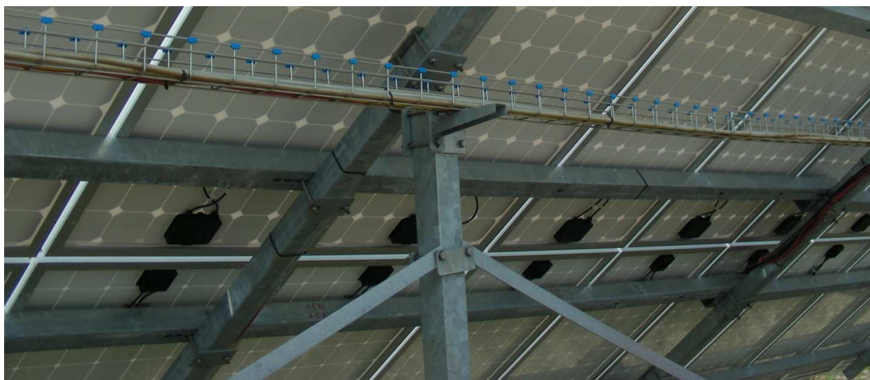
Lato posteriore dei moduli fotovoltaici su cui si notano le scatole di connessione provviste di diodi di by-pass.
